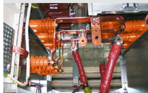
Фронтальное подключение силового кабеля
