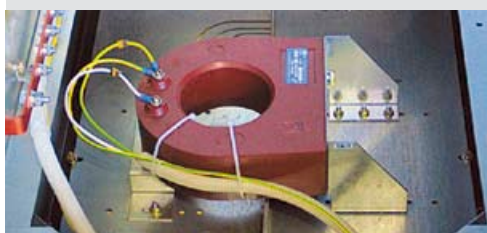
Трансформатор тока нулевой последовательности
