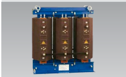
Трансформатор собственных нужд
