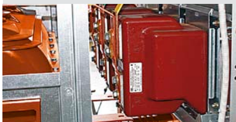
Трансформаторы тока в КСО 10 кВ
