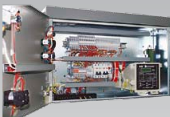
Отсек релейной защиты
